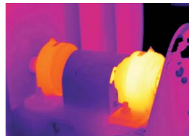
Přehřívání ložiskového víka
